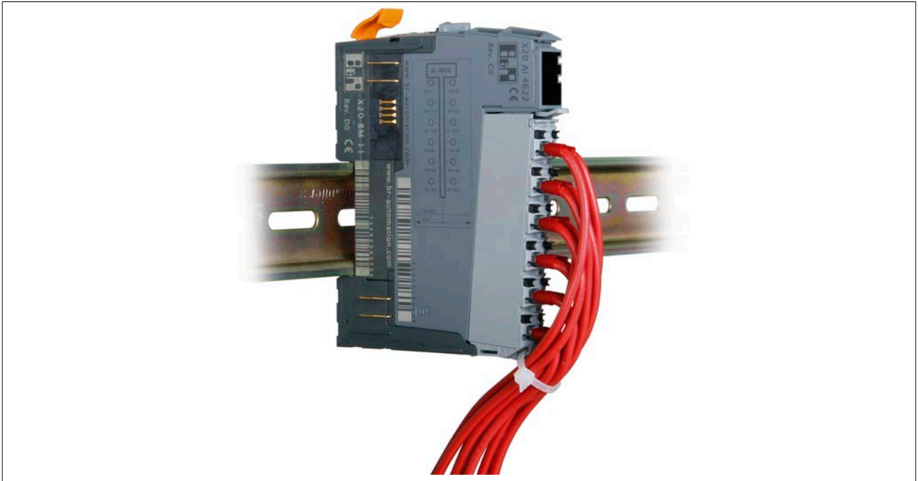
Abbildung 15: Zugentlastung durch Kabelbinder
